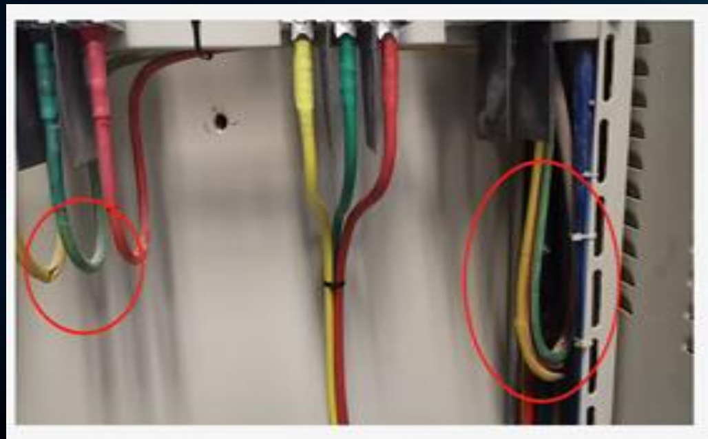
电缆绝缘层破损
